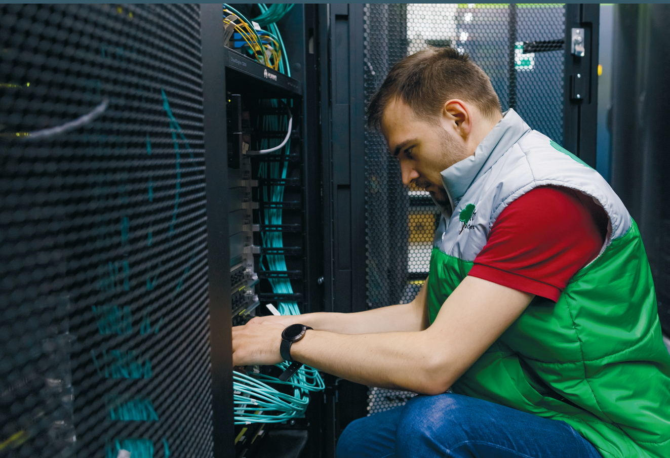
Подключение серверного оборудования в датацентре Zdata «У8»
