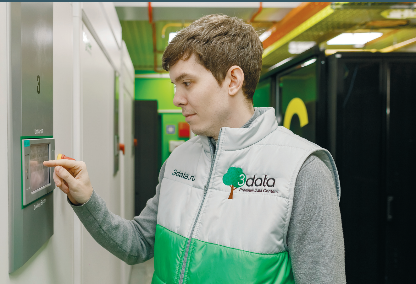
Настройка внутренних блоков кондиционеров в датацентре 3data «HP26»
